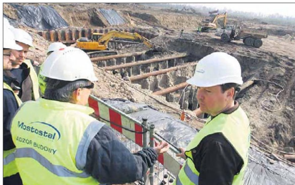
W tym miejscu zacznie się proces utylizacji śmieci. Po zalaniu betonem wbitych pali, powstanie bunkier do którego w przyszłości śmieciarki będą wrzucać odpady. Suwnica będzie podawać je na rozgrzany ruszt.
